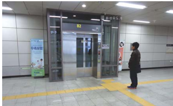
〈그림 2-36〉 음성유도기 설치 예시
