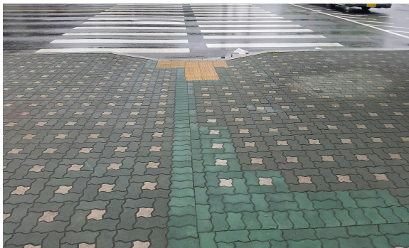
[양남사거리] 선형블록 4/5 설치 부적정
