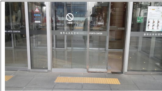
주출입구 가동문 폭에 맞지 않은 점형블록 설치-부적정(설치위치, 재질규격)
