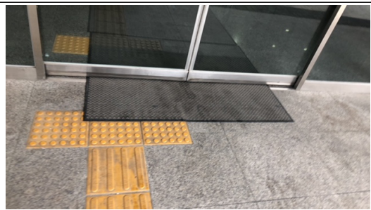
가동문 폭에 맞지 않은 점형블록 설치-부적정(설치위치)
